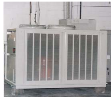
SPC (HLF 698) Gris Claro usado para revestir el exterior del gabinete de esta unidad de a/c.
