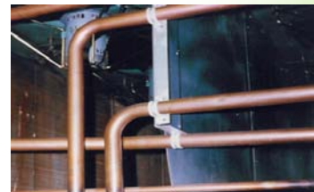
Tubería de cobre revestida con El protector transparente Sea Coast, que la protege contra la corrosión atmosférica en una planta de tratamiento de aguas negras
