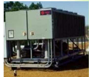
Unidad chiller revestida con “Husky SPC Transparente, para protegerla de los efectos corrosivos de un incinerador de gases y atmósfera de costa.
